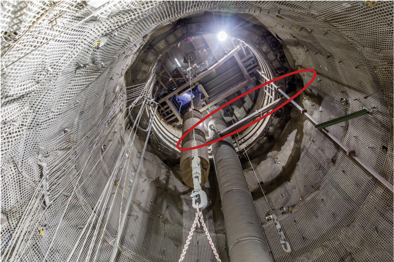
Abb. 4: Tachymeterträger im Schacht mit Kragarmen und Befahrungseinrichtung
