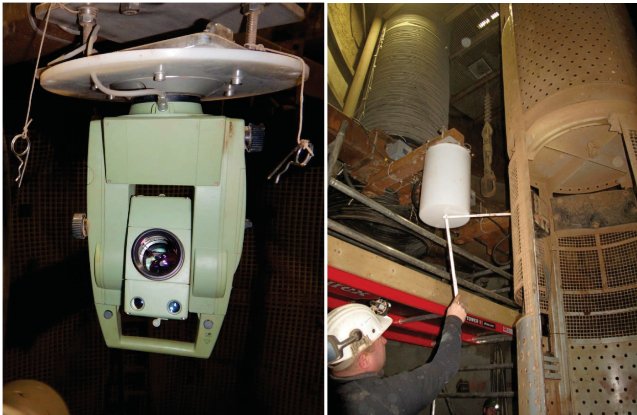
Abb. 3: links: Tachymeter in Aufhängevorrichtung, rechts: Einbausituation am Tachymeterträger-Kragarm mit Schutzhaube und Fahrkorb
